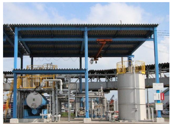
<増設したシリコン再資源化設備3号機>
